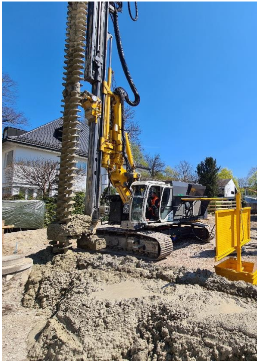
(2) Pilotprojekt von Bauer Spezialtiefbau in München: Neubau eines Wohnhauses mit Tiefgarage. © BAUER Gruppe
