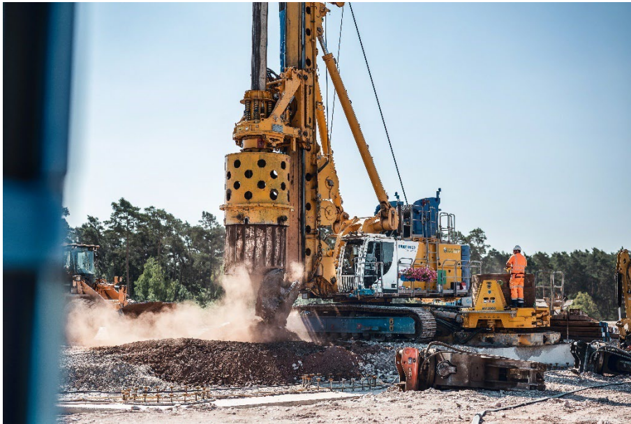
(2) Pfahl für Pfahl: Im Kellybohrverfahren entsteht die Umschließung der 30 m tiefen Hauptbaugrube.
